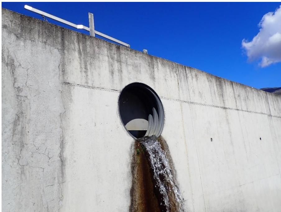
Figure 19 : Ouvrage traversant vanné sur le tronçon GC 47.2
